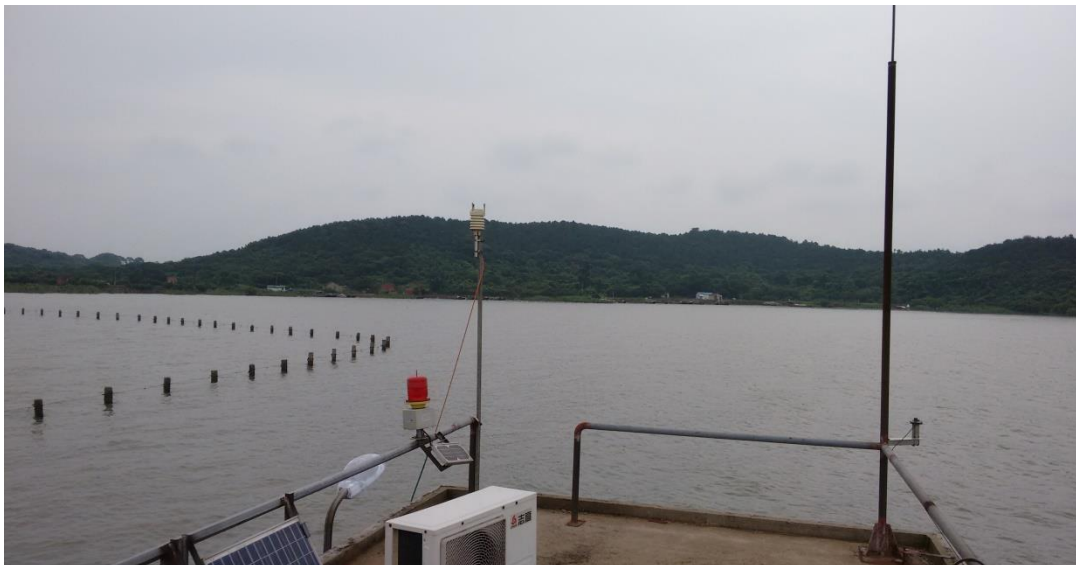
Abbildung 6: Visala Wetterstation auf dem Dach des Bootshauses am NIGLAS-Jetti (eigenes Foto)
